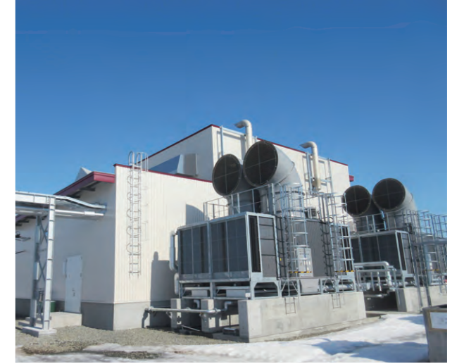
コージェネレーション設備
