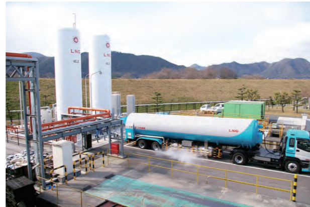
LNGサテライト設備
