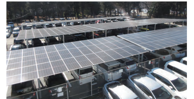
カーポート方式の太陽光発電設備
