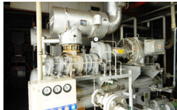
フリーザー用大型冷凍機（伊勢崎工場）
