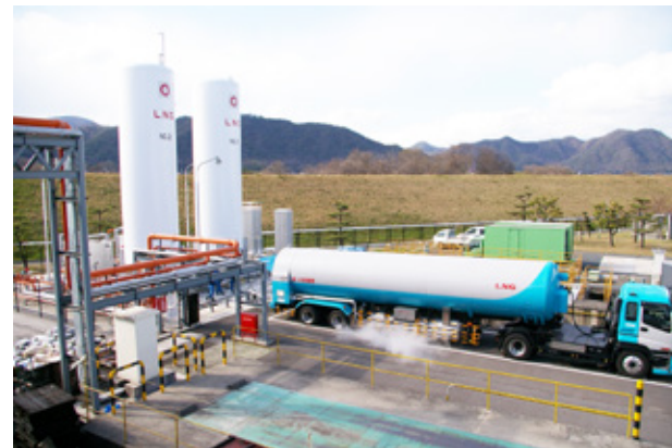
LNGサテライト設備（岡山工場）
