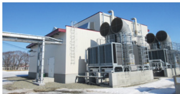
コージェネレーション設備導入（札幌工場）
