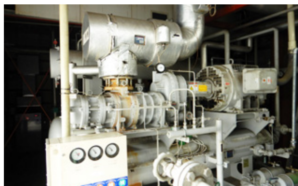
フリーザー用大型冷凍機（伊勢崎工場）
