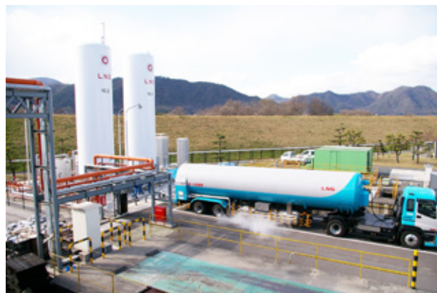
LNGサテライト設備（岡山工場）
