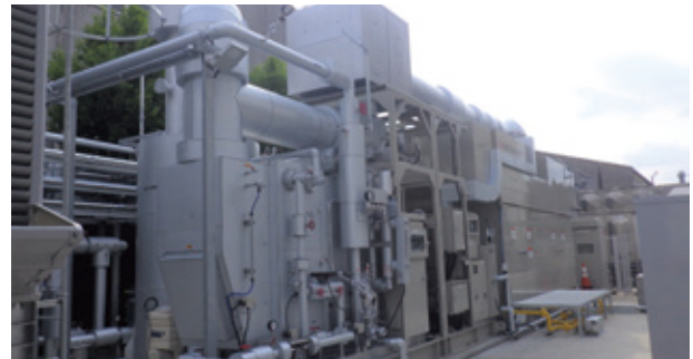
コージェネレーション設備導入（松戸第二工場）
