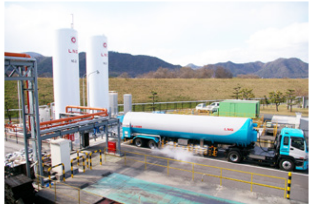
LNGサテライト設備（岡山工場）
