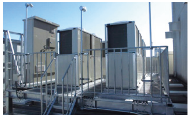
CO 2 冷媒冷凍機（安城冷生地事業所）
