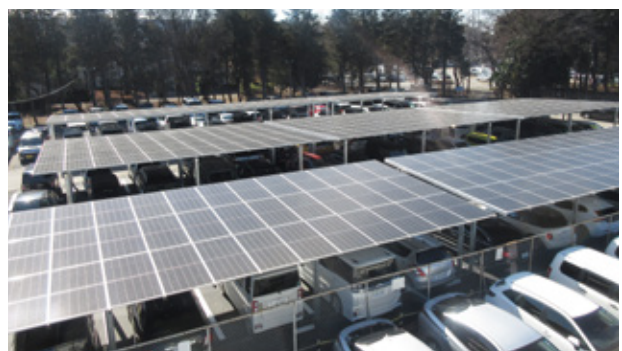
カーポート式太陽光発電設備（古河工場）
