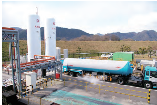
LNGサテライト設備
