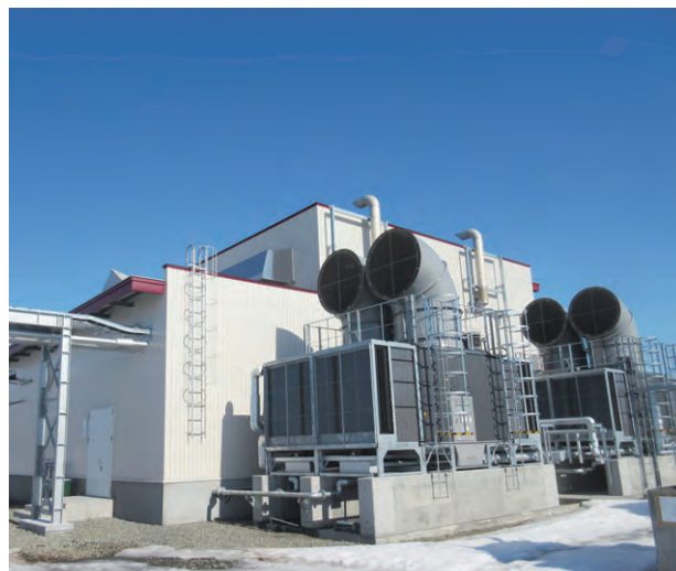
コージェネレーション設備
