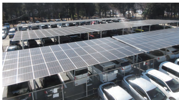
カーポート方式の太陽光発電設備
