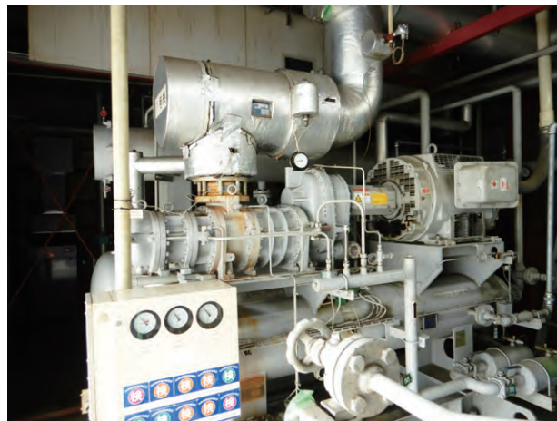
フリーザー用大型冷凍機
